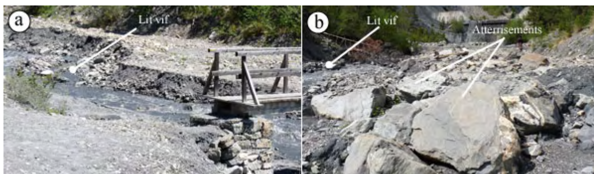
a. Incision du Riou-Bourdoux dans ses propres dépôts. b. Le volume des blocs qui constituent l'atterrissement témoigne de la puissance des crues et surtout des laves torrentielles.
